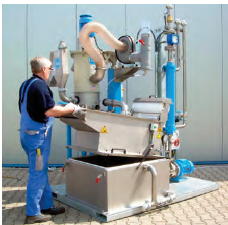
Temperiertes Wassersystem mit Bandfilter
